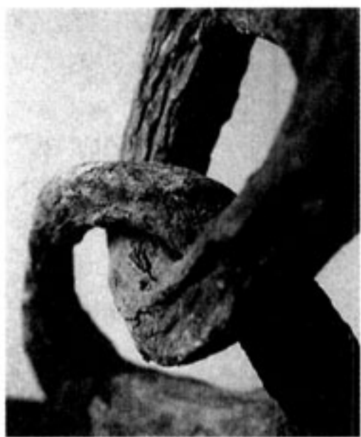
图 4-14 被腐蚀的金属
